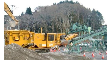
岩手県山田町地区 コンクリートくず破碎ライン (撮影日 H24.12.11)
