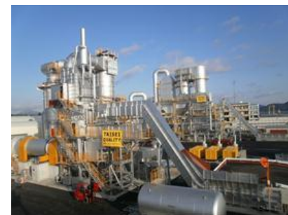
宮城県気仙沼市仮設焼却炉 (撮影日 H24.12.23)
