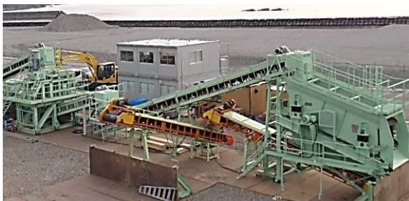
岩手県釜石市津波堆積物処理装置 (H25.3 設置)
