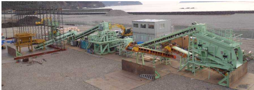
岩手県釜石市津波堆積物処理装置（H25.3 設置）
