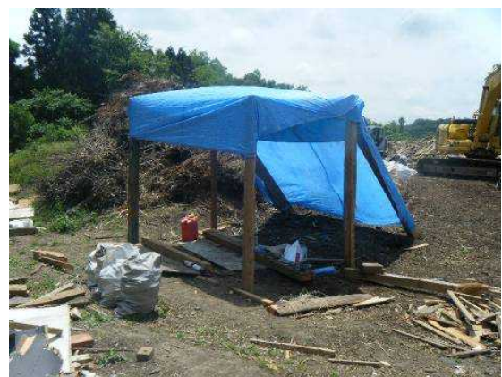
作業現場付近に設けられた休息所 (柱はガレキの一部を有効利用)
